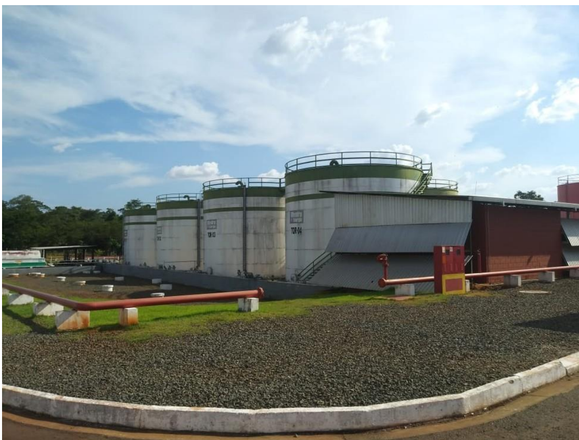
Termelétrica de Monte Cristo, em Boa Vista (RR), é a principal usina do parque gerador do estado —
