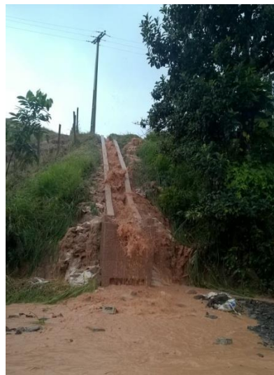
Figura 10. escoamento de água de chuva pela escadaria no mês de abril de 2017
