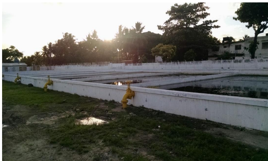
Figura 10. Leitos de secagem.
