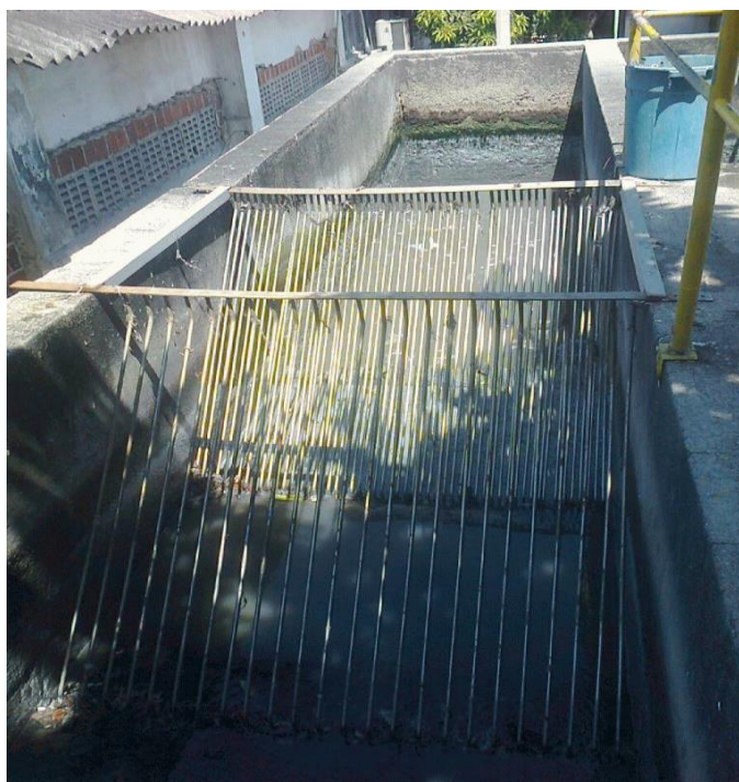
Figura 5. Gradeamento existente no canal de entrada da ETE.
